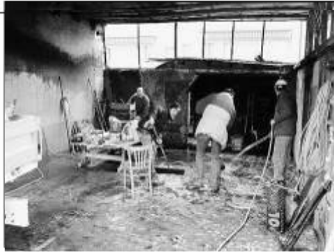
I danni provocati dall'incendio nel garage di via Cobelli
